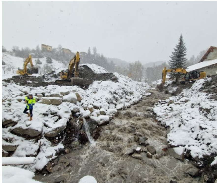
Les inondations de l'automne 2023 ont provoqué d'importants dégâts dans le département.
